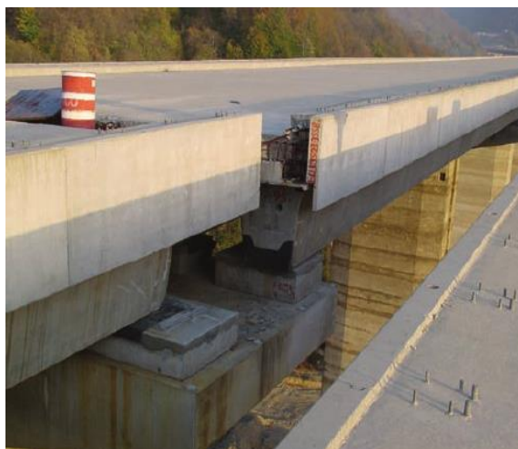
Рис.1. Повреждение виадукта Болу во время землетрясения в Дюзде 1999 г.
